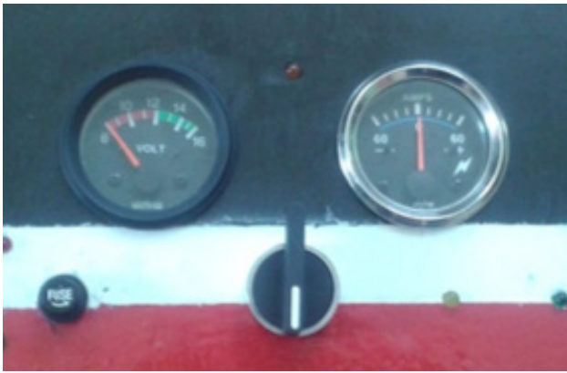
Figura 6. Módulo de control
