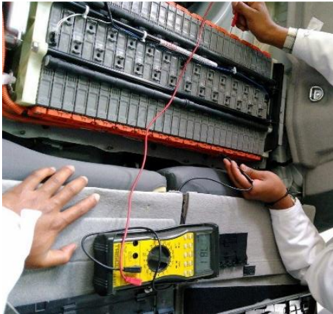
Figura 1. Medición de voltaje en batería de alto voltaje
