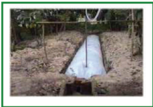
Biodigestor de polietileno
