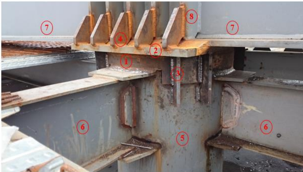
Figura 17b Conexión de la viga-puente con columna de suspensión, en etapa de construcción.
