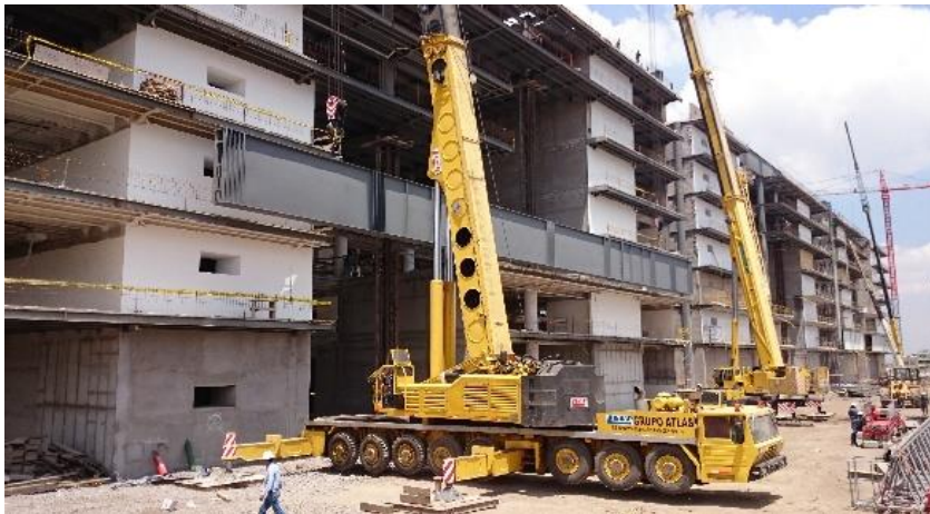
Figura 15a Montaje de vigas-puente de la Plataforma Gubernamental Social etapa inicial, grúas de 300 toneladas de capacidad.
