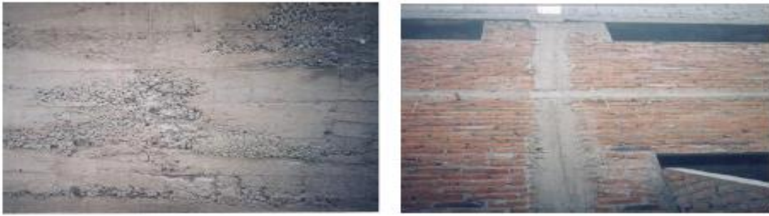
Figura 3 Mala calidad en la ejecución de obra, falta de control en obra
