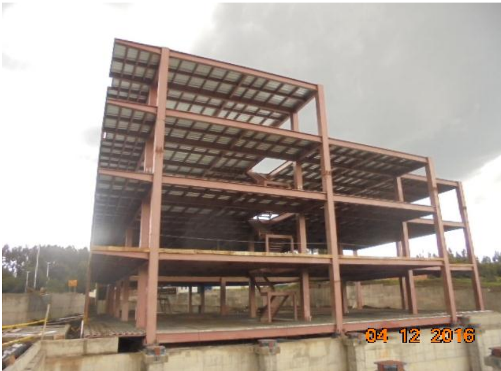
Figura 5 Bloque Estructural 1, del nuevo Centro de Investigaciones Científicas de Ciencias de la Tierra y la Construcción de la Universidad de Fuerzas Armadas ESPE, sobre aisladores sísmicos de triple péndulo de fricción.
