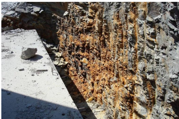
Fotografía 10.- Afectación al hormigón de cimentación
