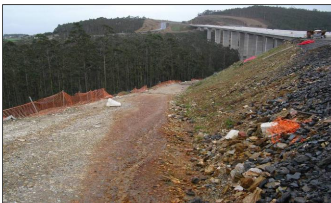
Fotografía 6.- Vista de terraplén con materiales de oxidación
