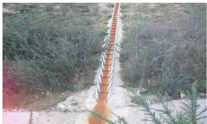
Fotografía 7.- Vista de terraplén con materiales de oxidación
