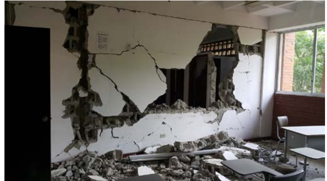
Fig. 1. Fallas en la mampostería por el sismo de 16 de abril de 2016
