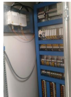
Fig. 5 Tablero de control del reactor MQ5
