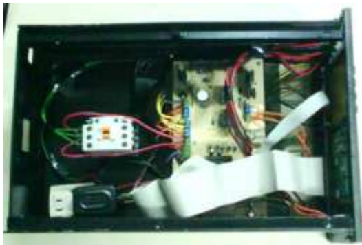
Fig. 18. Drive troceador DC/DC vista superior.
