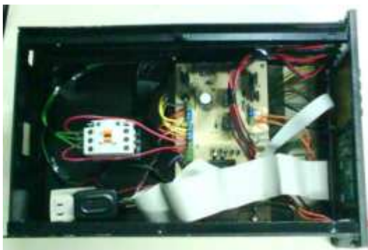
Fig. 18. Drive troceador DC/DC vista superior.
