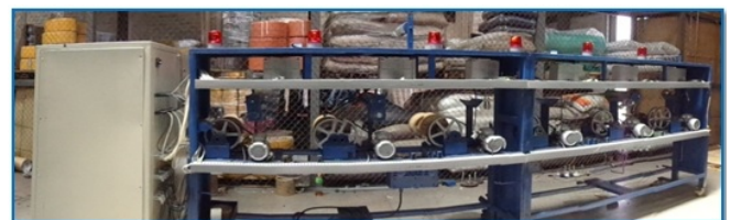
Figura 9. Canalización externa de actuadores y sensores
