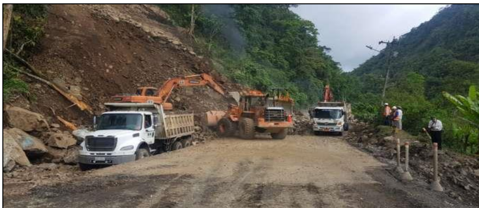
Figura 1. Deslizamiento en la vía Alóag – Santo Domingo. Fuente: (La Hora, 2019).
