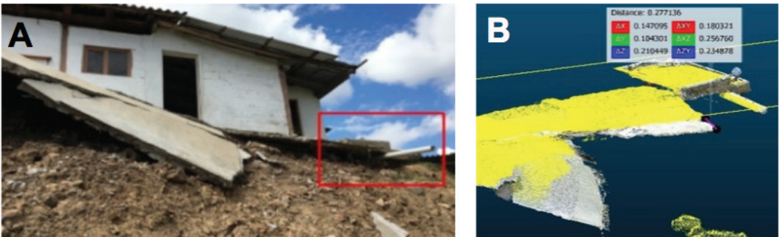
Figura 9. A: El recuadro rojo indica una porción de losa de la vivienda afectada por un deslizamiento secundario. B: Ese sector de la losa se ha desplazado 28 cm entre el escaneo de mayo (amarillo) y el de junio (RGB).
