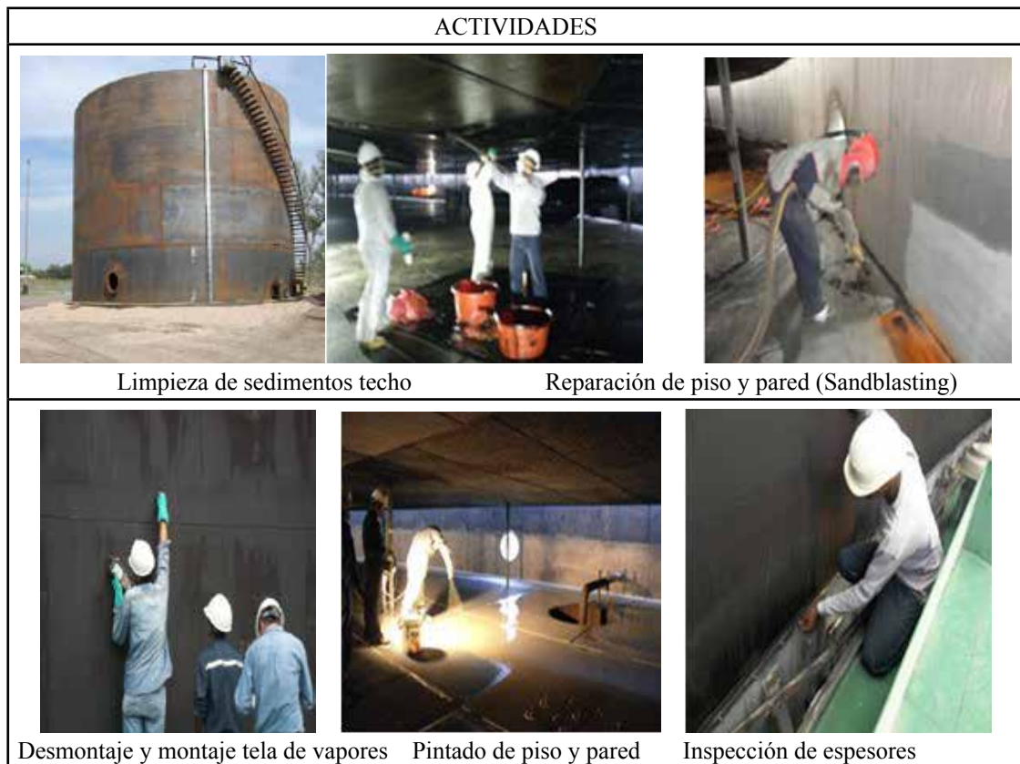
Figura N° 2. Ejemplos de actividades realizadas en el mantenimiento del tanque de almacenamiento de petróleo.
