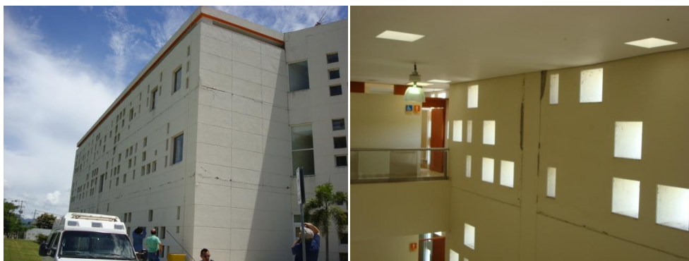
Figura 7 Daño típico extendido en muros diafragma de fachadas en el Hospital General Bicentenario de la Secretaría de Salud en las afueras de Villaflores, Chiapas, experimentado durante el sismo de Tehuantepec del 7 de septiembre de 2017. El hospital es de muy reciente diseño y construcción, pero no experimentó grieta alguna en vigas ni en columnas
