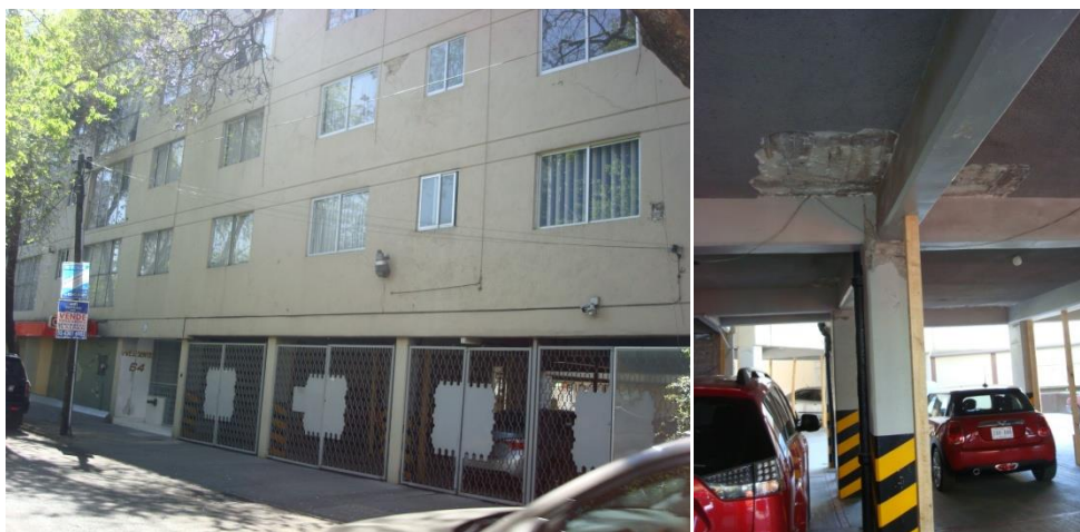
Figura 10 Daño típico en muros diafragma y en columnas de un edificio estructurado con base en marcos de concreto reforzado y con piso suave y débil ubicado en la colonia Portales Norte (suelos blandos) en la ciudad de México y construido a fines de los años ochenta. Obsérvese que no existen agrietamientos en las vigas de los marcos que componen el piso suave, ni se presentaron en el interior y exterior
