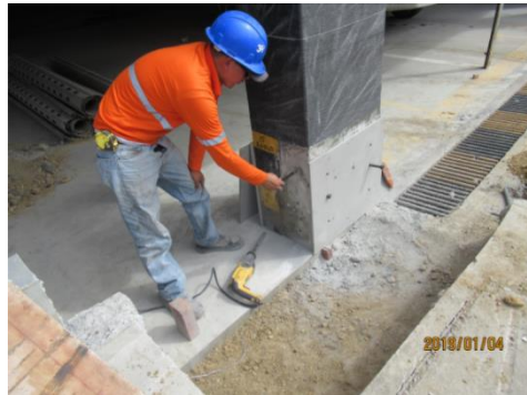
Figura 13 Pernos de anclaje químico de 16 mm, de diámetro y 15 cm, de longitud, para collarín en columnas donde van diagonales de acero en forma de V invertida.
