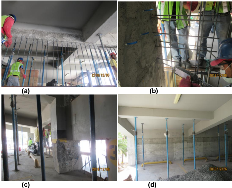
Figura 8 a) Armadura vertical compuesta por dos varillas para poder anclar 12 cm, en la viga superior e inferior; b) Inyección de epóxico antes de colocar la armadura horizontal del muro; c) Vista del tramo 5-6 se aprecia que entre columnas del eje D, se tienen vigas secundarias; d) Muro fundido en el tramo 5-6 en que se ve las vigas secundarias y vigas terciarias.
