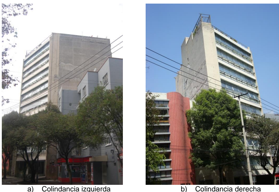
Figura 16 Daños ligeros observados en los muros de colindancia del Edificio Parque España en la dirección N-S después del sismo del 19 de septiembre de 2017. Se presentó choque estructural ligero en ambas colindancias
