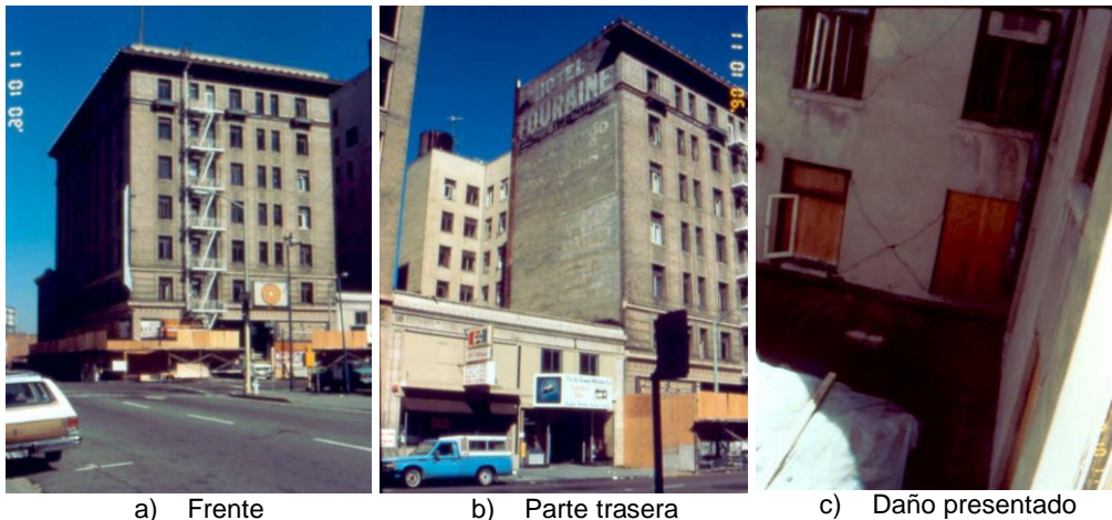
Figura 8 Vista general del Hotel Tourraine en Oakland y daño observado
