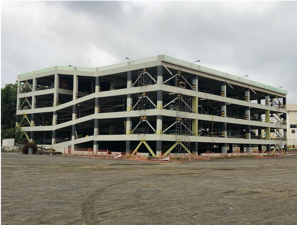
Figura 11 Panorámica de la estructura del Ex Parquadero de la ULEAM que fue reforzado con diagonales, disipadores de energía TADAS, encamisado con acero de columnas y creación de un muro en la parte central. El pórtico de la derecha es el analizado en el ejemplo.
