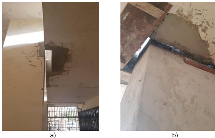
Figura 6 a) y b) Picado de bordes de losas en zonas de impacto con columnas.
