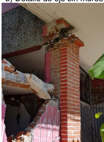
d) Detalle de falla en columna
