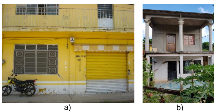
Figura 16 Daños observados en viviendas de mampostería deficientemente confinadas en Matías Romero, Oaxaca.
