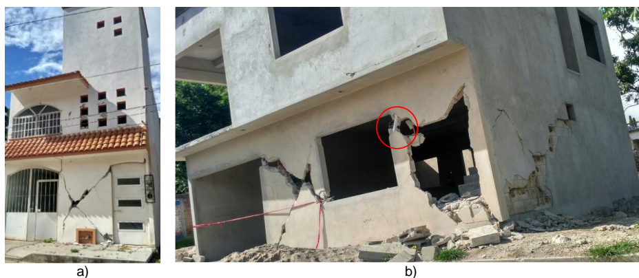
Figura 18 Daños en viviendas ubicadas en la ciudad de Berriozábal, Chiapas.
