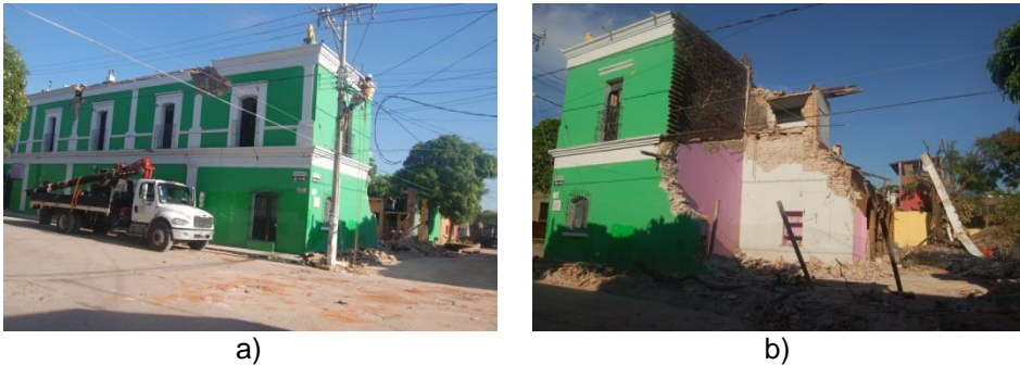
Figura 11 Colapso parcial fuera del plano de muros adosados de mampostería de ladrillo simple en una casona colonial ubicada en Juchitán, Oaxaca.
