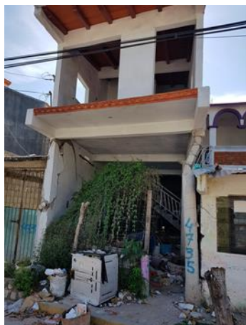
a) Choque estructural
