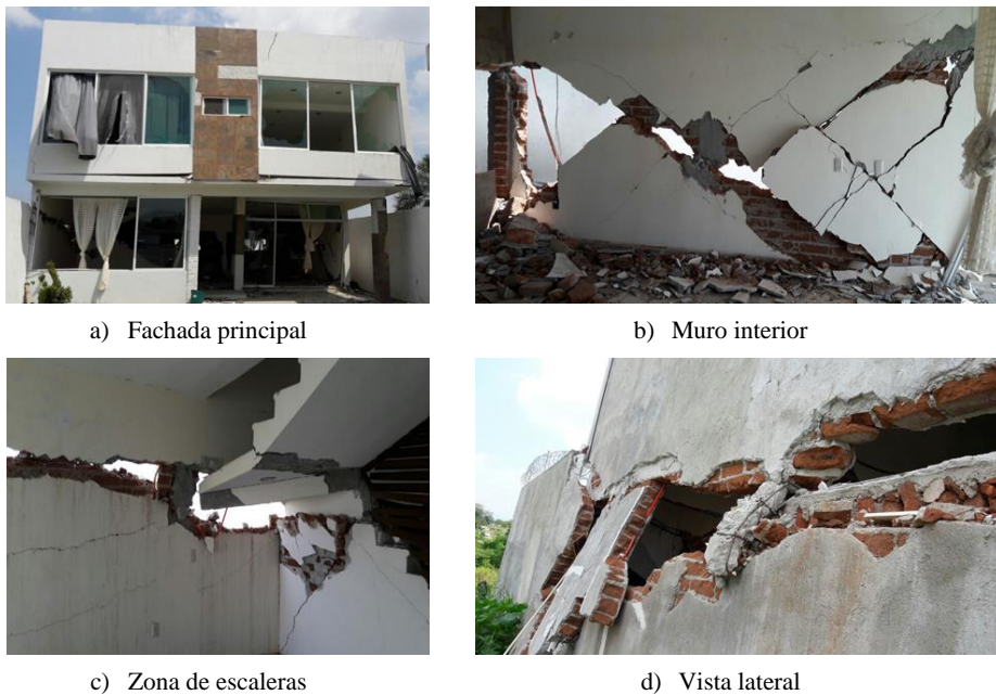
Figura 19 Daño estructural muy grave en vivienda residencial ubicada en la ciudad de Tuxtla Gutiérrez, Chiapas (fotografías cortesía del Ing. Christian Burguete D'Artote).
