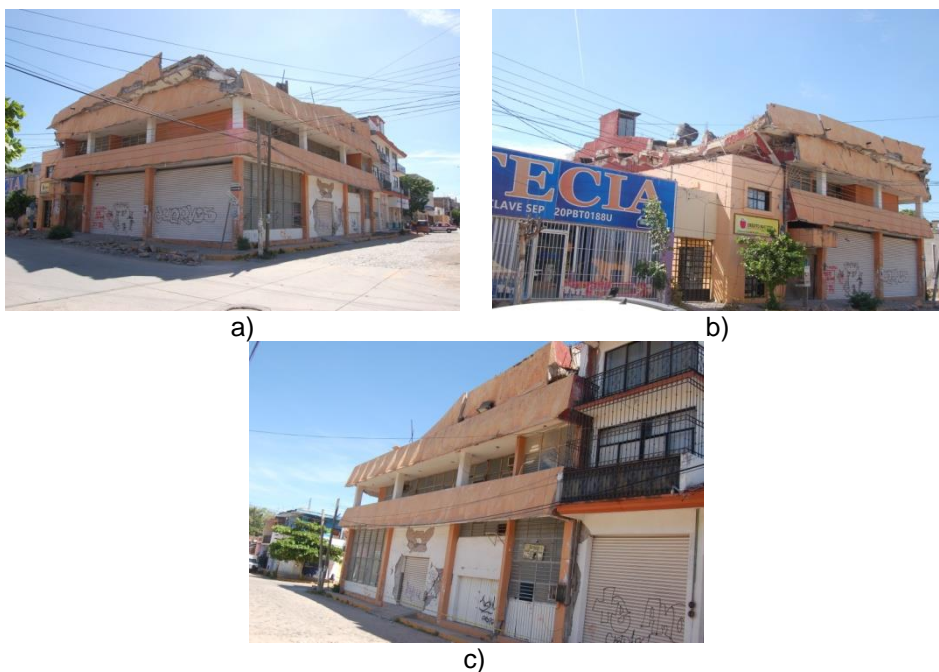
Figura 25 Colapso de vivienda en esquina por entrepiso débil en la ciudad de Juchitán, Oaxaca.
