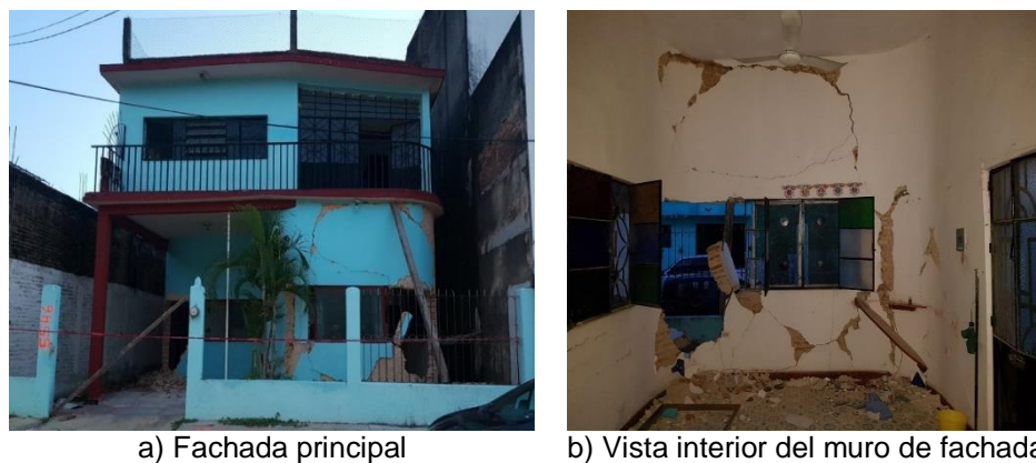
Figura 13 Daños en vivienda de mampostería simple ubicada en la ciudad de Tonalá, Chiapas.
