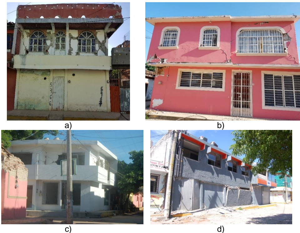
Figura 15 Daños observados en viviendas de mampostería deficientemente confinadas, ocasionados por diferentes errores de diseño/constructivos en Juchitán, Oaxaca.
