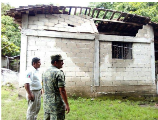
Figura 14 Volteo de muro de mampostería deficientemente confinada fuera de su plano por la ausencia de soporte lateral, Pijijiapan, Chiapas.
