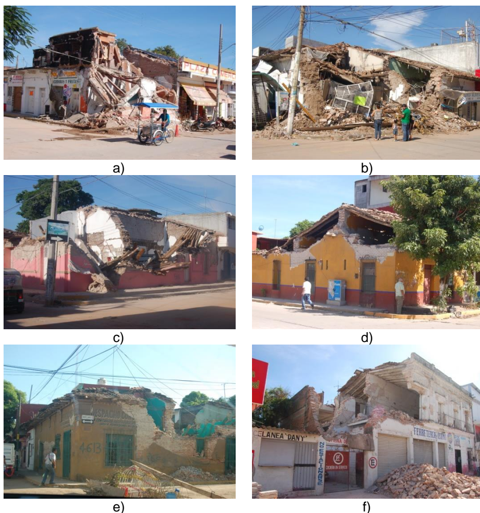
Figura 10 Algunos de los colapsos fuera del plano en muros de adobe o mampostería simple en Juchitán, Oaxaca.
