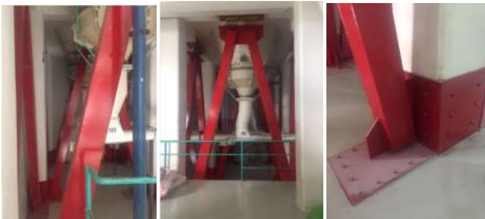
Figura 2 Dos disipadores TADAS de 6 placa cada uno, colocado sobre diagonales de acero en forma de "V" invertida y conexión soldada entre diagonal y placa Gusset, en reforzamiento de Molinos Superior. Aguiar y Del Castillo, 2016.
