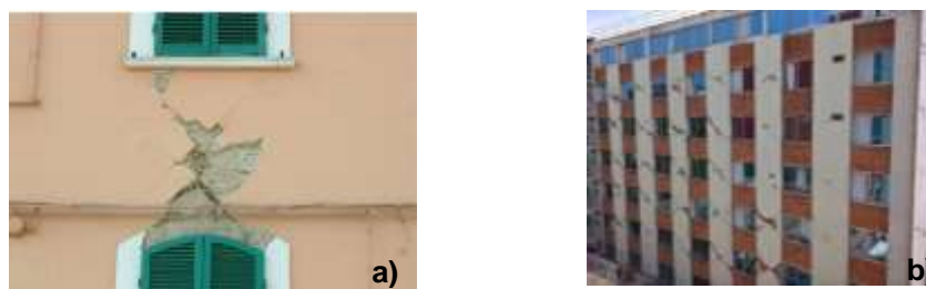
Figura 12. Daño en estructuras de mampostería: a) Falla en corte de pretil en estructura de mampostería simple (Dazio y Beyer 2010); b) Falla en corte de muros en edificio de mampostería confinada
