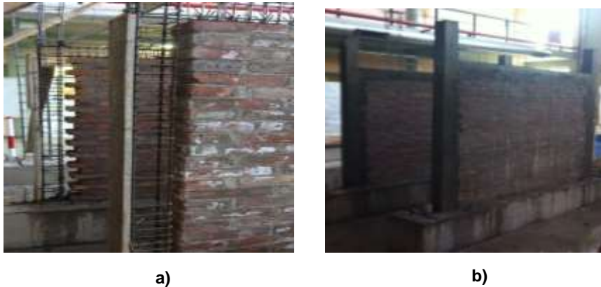
Figura 5 Proceso constructivo de los muros MC y MCD: a) llenado de los elementos de confinamiento de hormigón armado; b) panel de mampostería.
