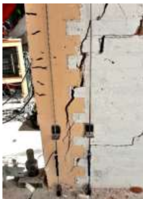
Figura 16 Separación del panel de mampostería por fisuración del hormigón y/o de los ladrillos en las interfaces dentadas.
