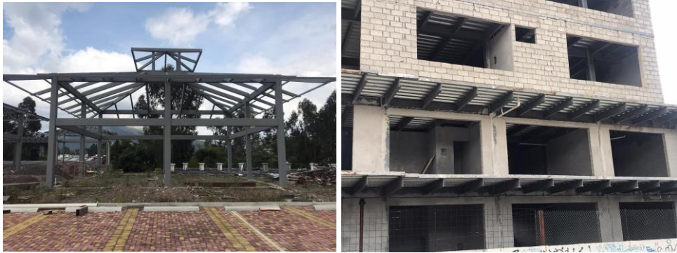
Figura 1 Estructuras de acero en el Valle de los Chillos; a la izquierda un centro comercial y a la derecha una edificación de apartamentos.
