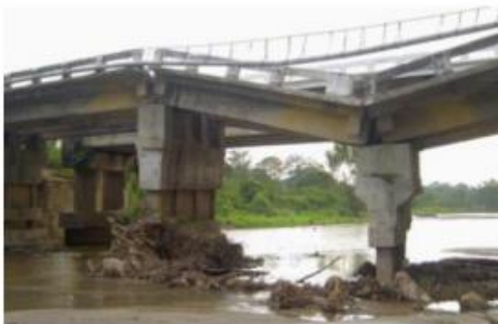
Figura 8 Daño en el puente Tepuzapa (Rivera et al. , 2006)
