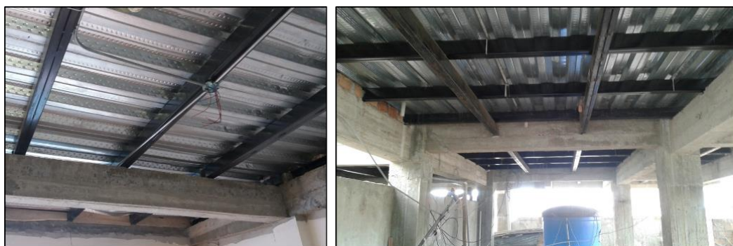
Figura 4 Nudos de viga secundaria con apoyo móvil. (a) Nudo de apoyo móvil. (b) Malla espacial en dos direcciones con apoyo móvil y empotrado.
