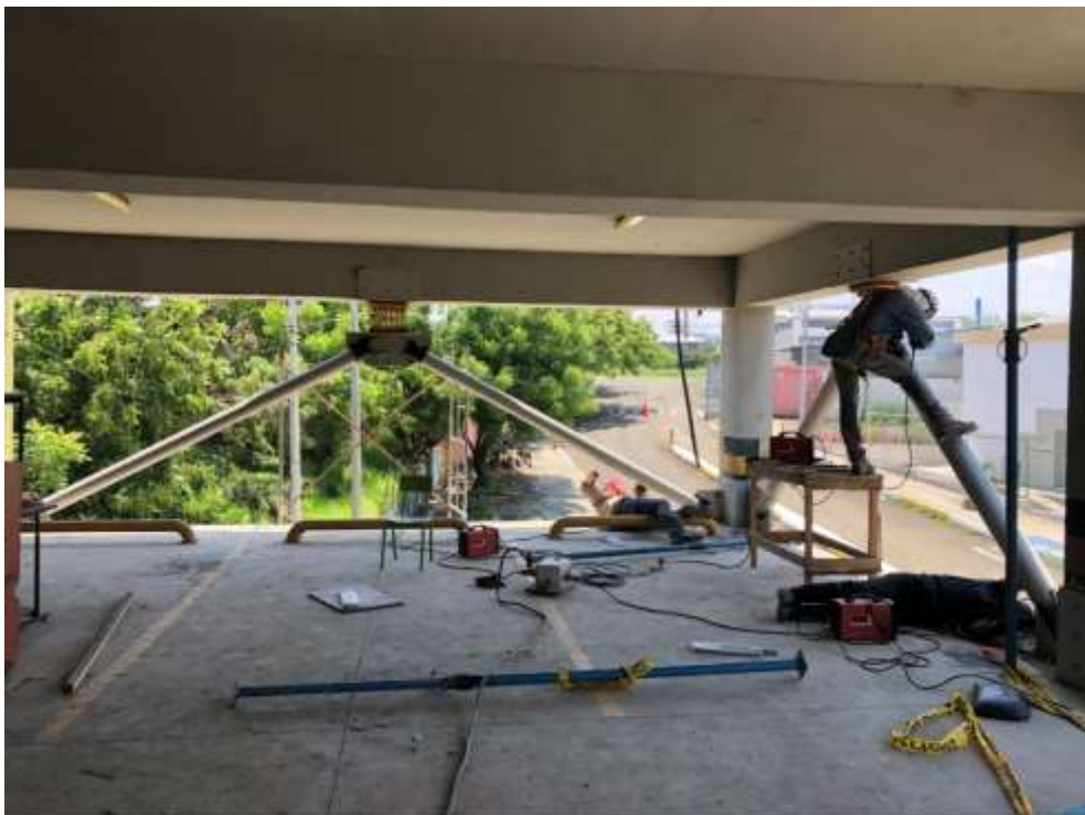
Figura 35 Disipadores TADAS sobre diagonales concéntricas en el tercer piso de parqueadero de ULEAM.
