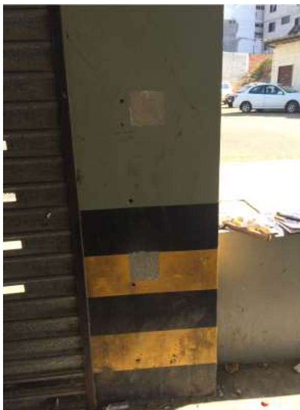
Figura 17 Estado en que quedó la columna F6 en planta baja después del terremoto del 16 de abril de 2016 (M=7.8)
