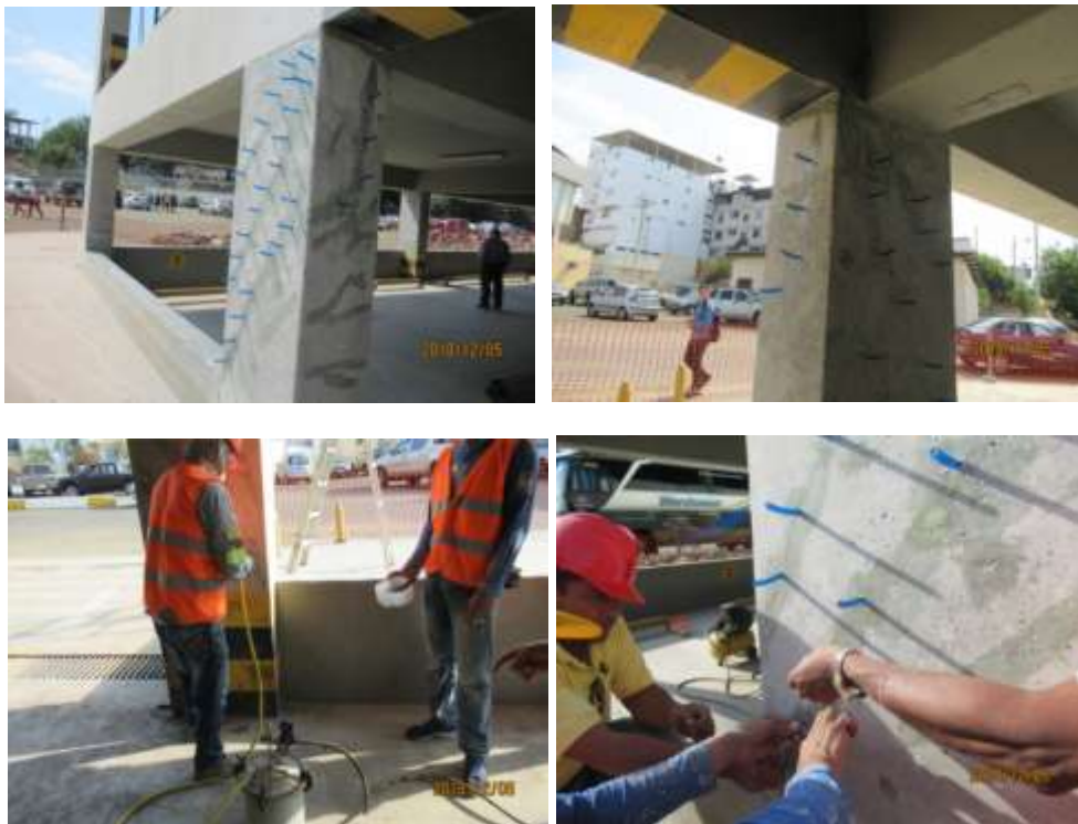
Figura 18 Colocación de resina epoxi en la columna F6, en planta baja. Las fotografías superiores muestran los tubos en los sitios que se van a realizar las inyecciones que se muestran en las fotografías inferiores.
