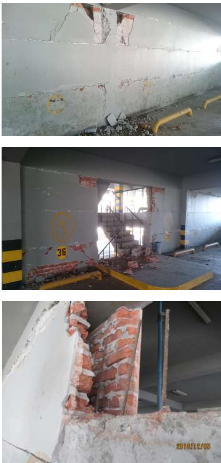
Figura 22 Falla de columna corta en Pórtico D, de parqueadero de ULEAM; en la fotografía inferior se ve la mampostería.
