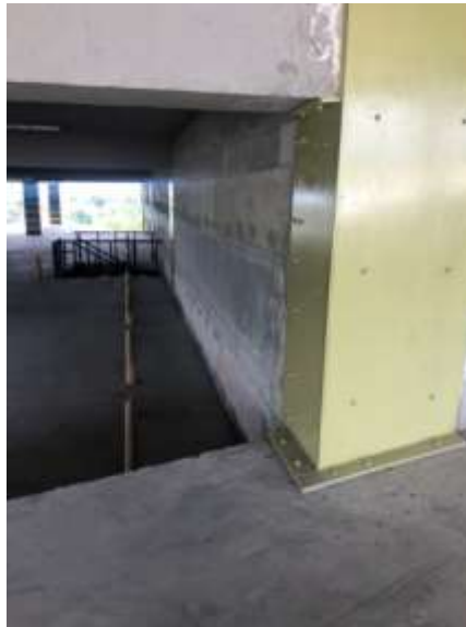
Figura 44 Muro en el Pórtico D, con columnas que pasan a trabajar como cabezales, reforzadas con placas de acero, se observa la grada central en el Piso 4
