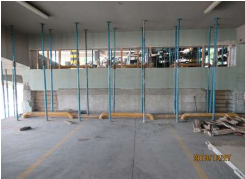
Figura 25 Daño en columna corta del Eje D, en la parte superior y en la inferior se observa el muro que se ha reforzado hasta 1 m, antes de cada columna. Fuente: Aguiar y Del Castillo (2019).
