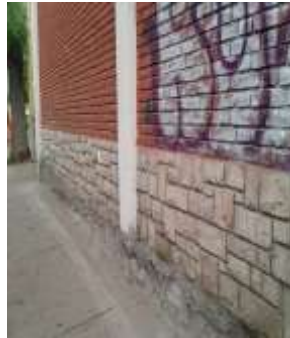
Figura 8. Degradación del hormigón y la armadura en pie de columna
