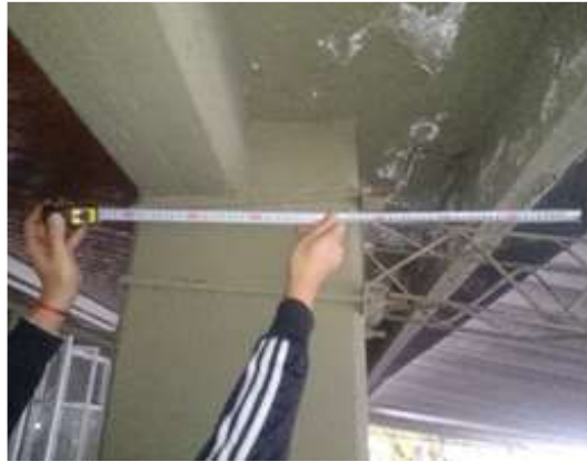
Figura 4. Patología en losa y gran excentricidad entre viga y columna de pórtico.
