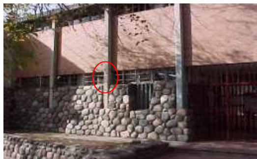
Figura 13. Problemática de columna corta en todo el frente del edificio.
