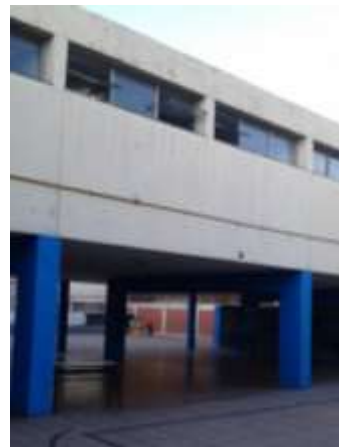
Figura 17: Piso flexible en planta baja y columna corta en planta alta.
