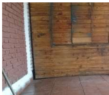
Figura 19: Hundimiento de la estructura. Deformación del piso.
