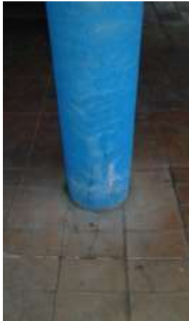
Figura 14: Rotura pie de columna y punzamiento.
