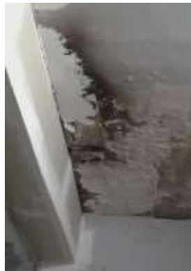
Figura 11. Patología en losa por rotura de desagües de baños.
