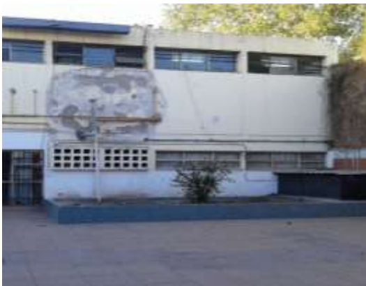
Figura 16: Patología en mampostería y columna corta en planta alta.
