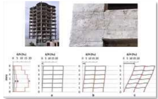
Figura 2. Edificio sin mampostería de sismo 2016.
