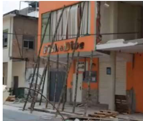
Figura 3. Ejemplo incorrecto de apuntalamiento. Manta-Ecuador
