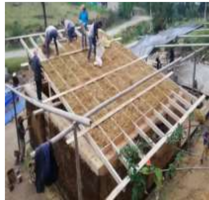
Figura 5. Colocación de paja humedecida con agua y cal en el techo para evitar puentes térmicos
