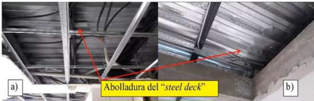
Figura 1. Daños en loseta de hormigón. Figura 2. Daños en placa colaborante.
