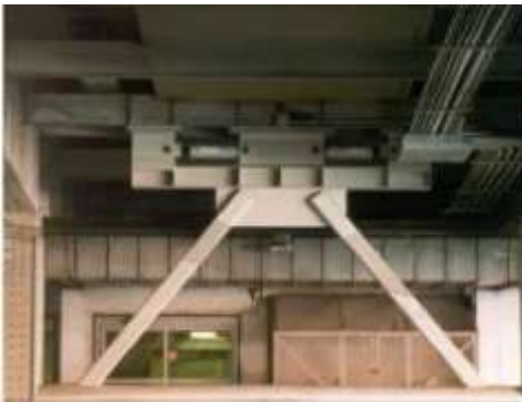
Figura 3. Disipador de energía Chevrón.
