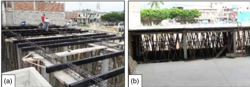
Figura 15. (a) y (b) Conexión inapropiada en el nudo híbrido entre la viga principal de HA y la viga secundaria de acero.
