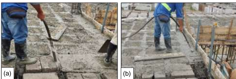
Figura 7. (a) y (b) Posicionamiento incorrecto de la aguja del vibrador, no existe la verticalidad requerida para un buen resultado de vibrado.
