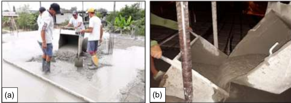
Figura 8. (a) y (b) Relación agua cemento incorrecta.
