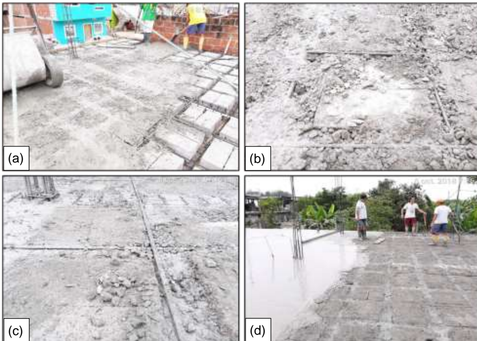
Figura 2. (a) Hormigonado de vigas y nervios por etapas. (b) y (c) Disgregación de los materiales. d) Hormigonado por etapas de la losa.
