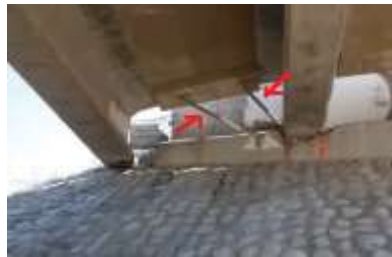
Figura 3. Daño en anclajes sísmicos verticales
