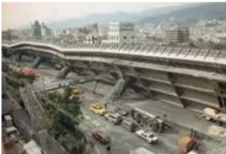
Figura 4. Viaducto Hanshin Kobe, Japón 1995
