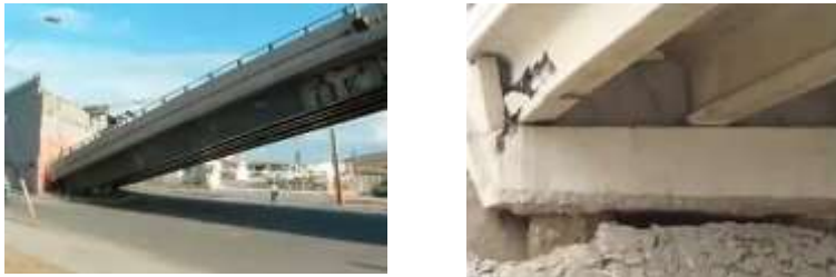
Figura. 1-2 Daño de puentes en el Terremoto de Maule 2010
