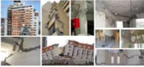
Figura 1 Daños después de un sismo.
