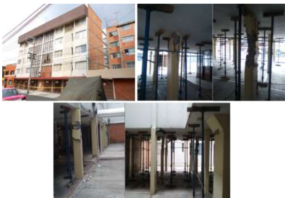
Figura 4. Azores No. 609 (edificio frontal), daño resultante después del sismo del 19 de septiembre del 2017 (Grande 2017)
