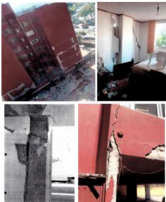
Figura 5. Canal de Miramontes No. 3004, daño resultante después del sismo del 19 de septiembre del 2017 (De Legarreta 2017)
