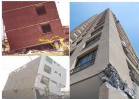
Figura 1. Falla estructural en columnas de planta baja derivado de una configuración de piso suave (Aguiar 2011)
