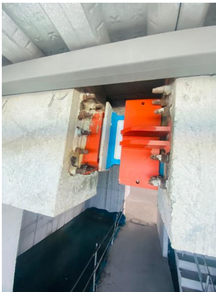
Figura 5. Disipador SLB de cuarta generación colocado entre vigas cortas en núcleos de hormigón. A la izquierda el espacio para los ascensores y a la derecha las gradas.
