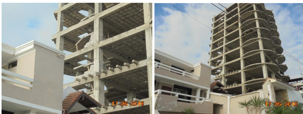
Figura 3 Colapso de gradas en algunos pisos de edificio flexible ubicado en Manta.
