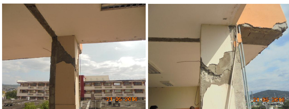
Figura 8 Falla oculta de corte en una de las columnas del Bloque de Gradas.
