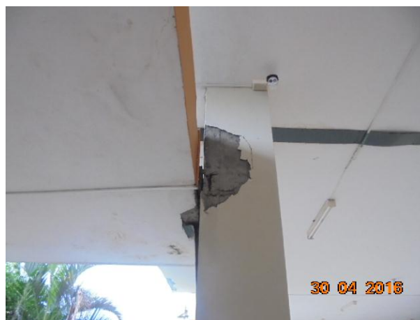
Figura 3 Daño columna a nivel de enlucido y recubrimiento por impacto de la losa durante el terremoto del 16 de abril de 2016
