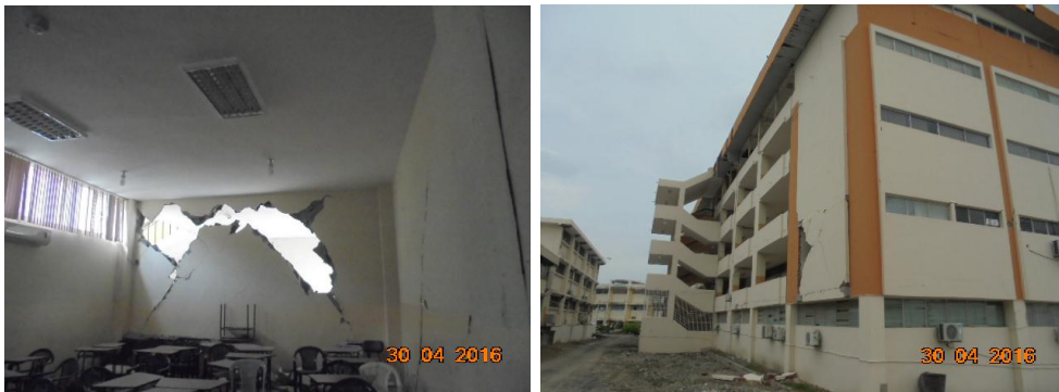
Figura 5 Fallas en grandes áreas de mampostería sin elementos confinantes.
