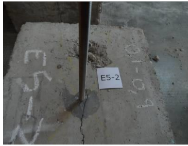
Figura 6: Bloque de hormigón con fisura incrementada luego de colocado el anclaje.
