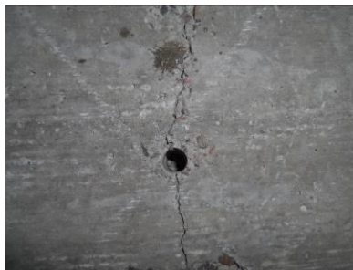
Figura 5: Bloque de hormigón con fisura marcada previo a la colocación del anclaje.
