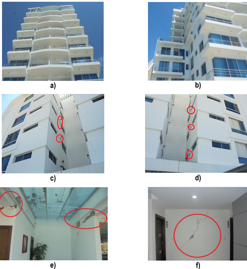
Figura 3 a) Vista posterior; b) Vista Lateral; c), d) Fachada principal con entrantes; e), f) Daños en mampostería
