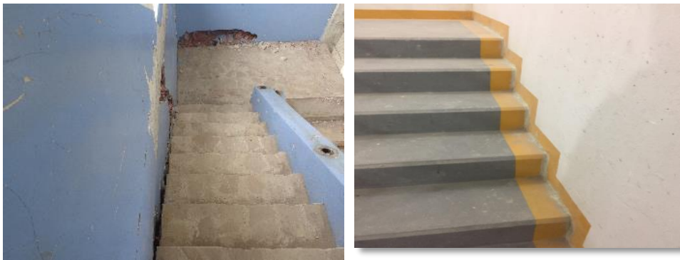
a) b) Figura 16 Desprendimiento de grada; a) Grada de Edificio Banco Central; b) Grada resanada de Edificio Buzios. Fuente: Aguiar (2017)
