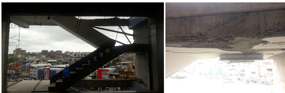
Figura 15 Daño entre moderado y extensivo en elementos estructurales de grada
