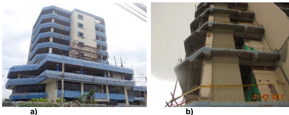
Figura 14 Derrocamiento de antepechos; a) Fachada lateral después del terremoto; b) Fachada sin antepechos.
