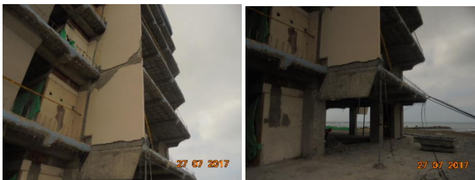
Figura 13 Pantallas de hormigón armado que fueron derrocadas y las paredes se reconstruirán con fibrocemento.
