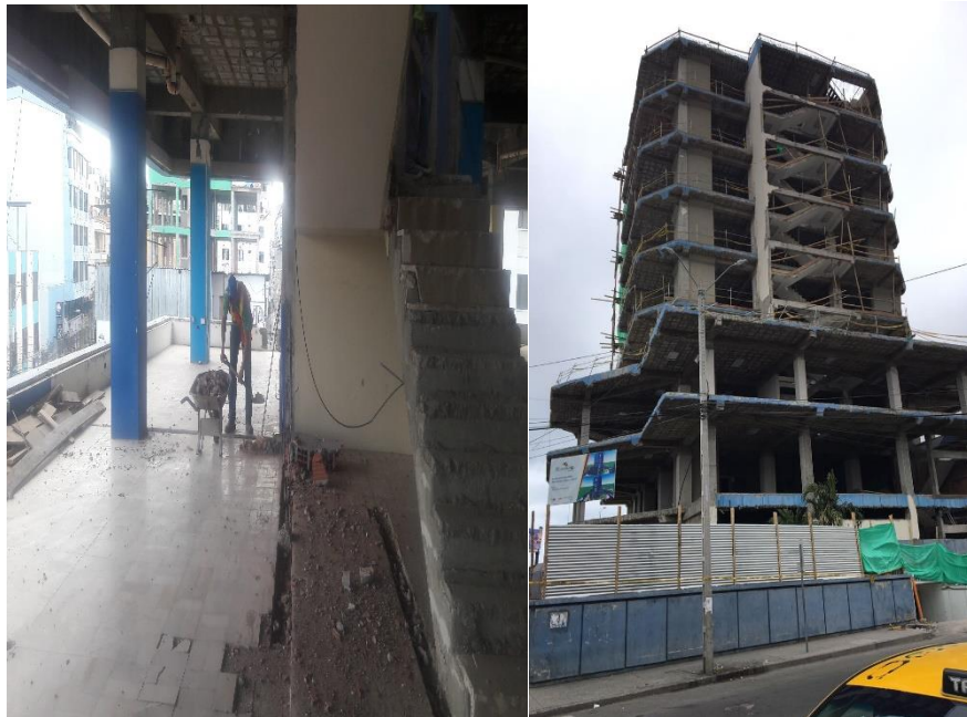
a) b) Figura 17 a) Vistas interior de área de grada; b) Vista lateral exterior de las gradas sin mampostería y sin antepechos.
