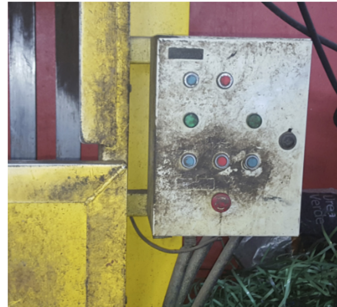
Figura 2. Tablero prensa hidráulica 1 sin funcionamiento, 2017.
