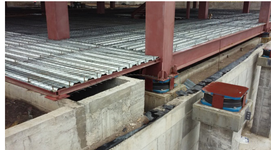
Figura 4. Aisladores sísmicos en el Nuevo Centro de Investigaciones Científicas ESPE
