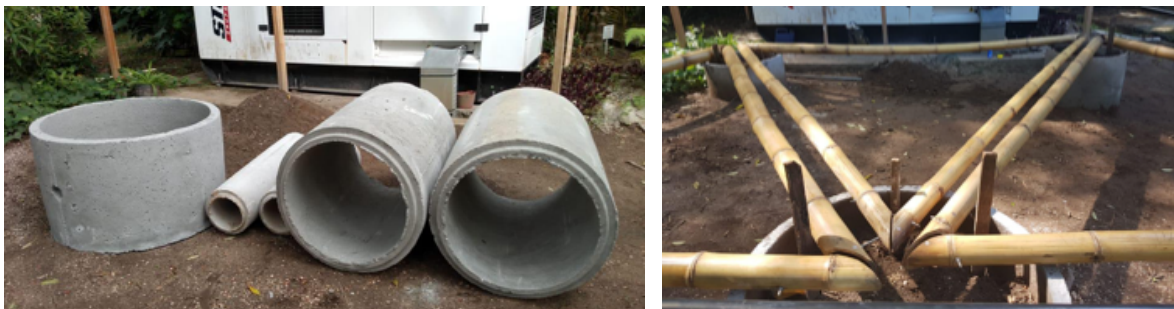
Figura 11. Tubos de cemento para fundición (izq) y demarcación con la ayuda de los módulos (der).
