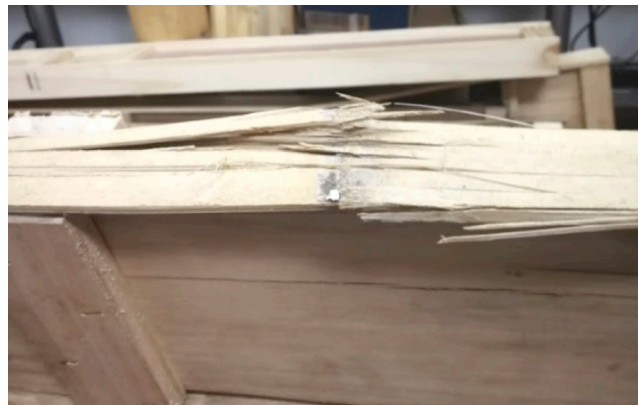
Figura 19. Falla por tension de las fibras del patin inferior.
