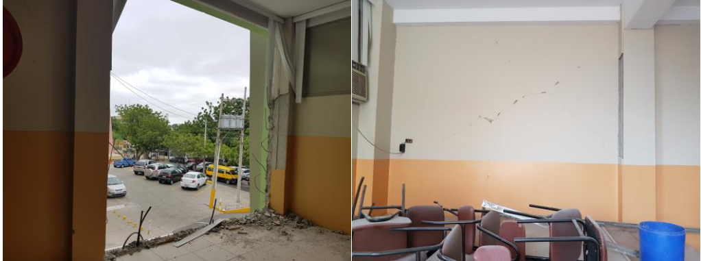
Figura 5 Colapso y fisuramiento en paredes de la primera plana alta
