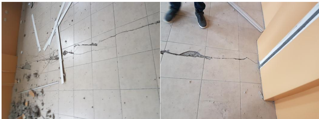
Figura 7 Agrietamiento en losa producto de la juntas
