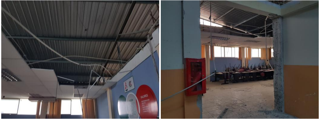
Figura 8 Caída de plafones en el piso superior del bloque tres de la facultad de administración
