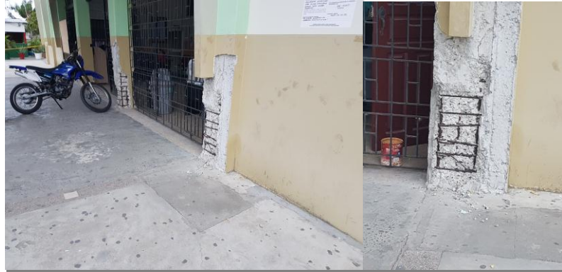
Figura 4 Desprendimiento del hormigón en pie de columna.
