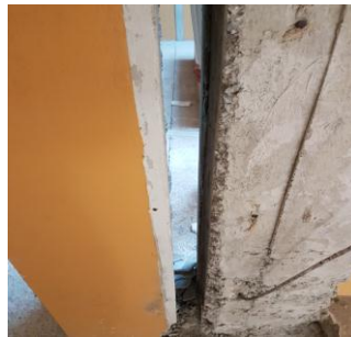
Figura 6 Separación de las juntas
