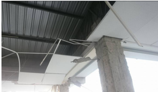
Figura 6 Caída de plafones en el piso superior del Bloque 2 de Economía.
