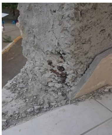
Figura 4 Columna D2 desprendimiento de hormigón
