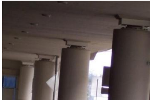
Figura 6 Aisladores Sísmico en el puente peatonal del Aeropuerto de Quito. Fuente: Quiport
