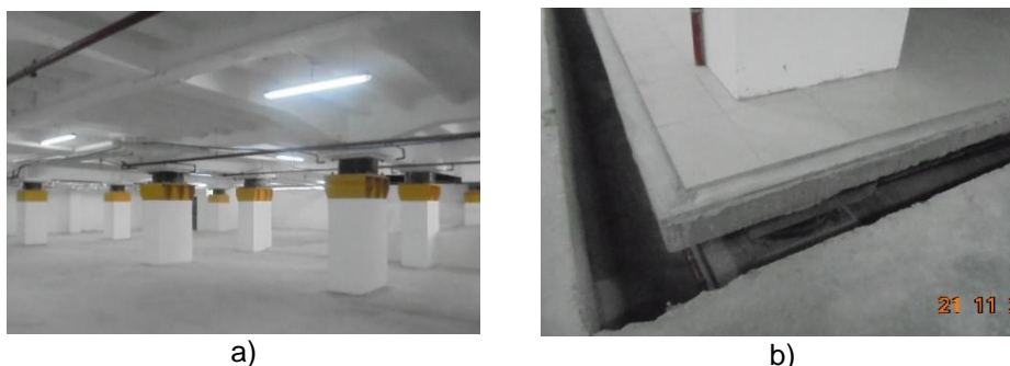
Figura 9 a) Aisladores se encuentra sobre columna de subsuelo; b) Aisladores del bloque de ascensor y gradas se halla sobre los plintos.
