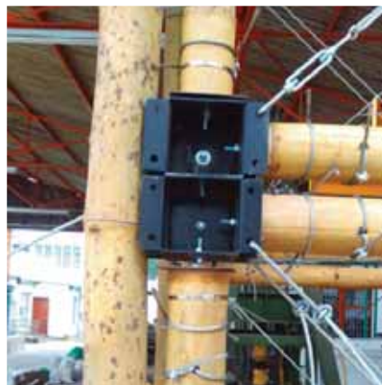
Figura 16. Verticalidad de estructura.
