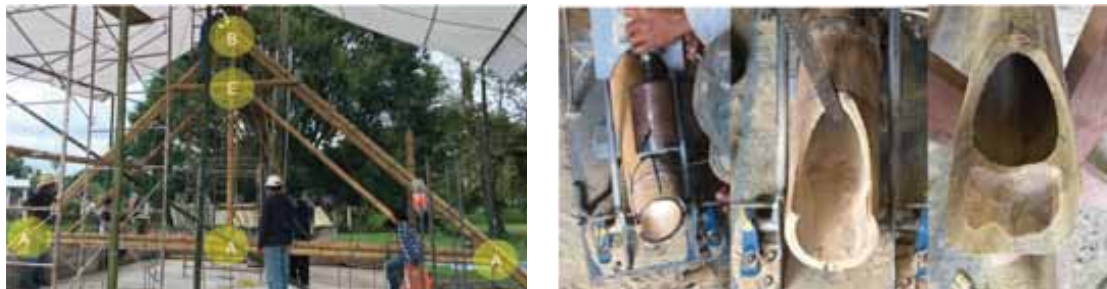
Figura 14. Armadura, uniones y elementos componentes. Tipos de cortes, utilizados en las uniones.
